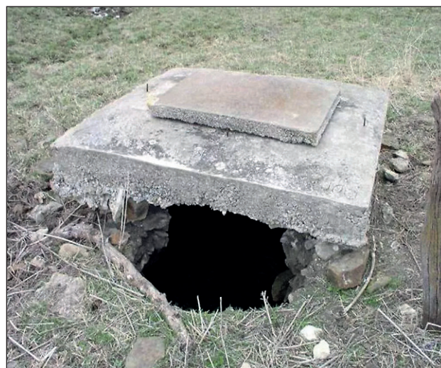
Рис. 3. Последствия ликвидации скважины по «типовому проекту»
