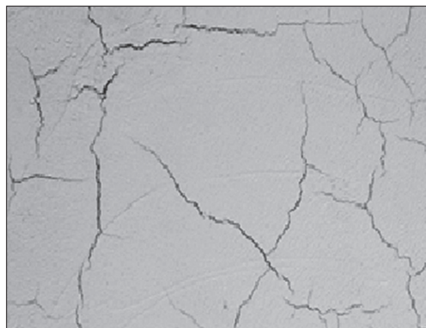
Рис. 2. Покрытие фасада здания по улице Калинина после 3-х лет эксплуатации, г. Пенза
